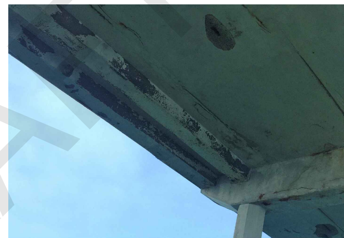
LONGITUDINAL BEAM DAMAGE
